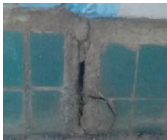
Рис. 2. Пошкодження стику стінових панелей (неремонтованого)
