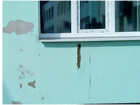
Рис. 10. Механічні пошкодження системи утеплення
