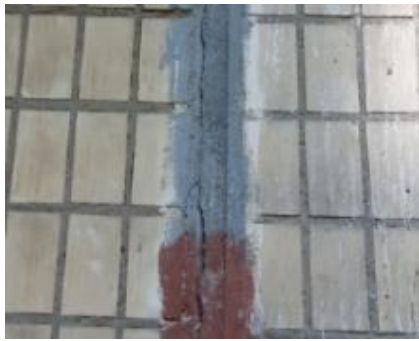
Рис. 3. Пошкодження стику стінових панелей (певний час після ремонту тільки цементно-піщаним розчином)
