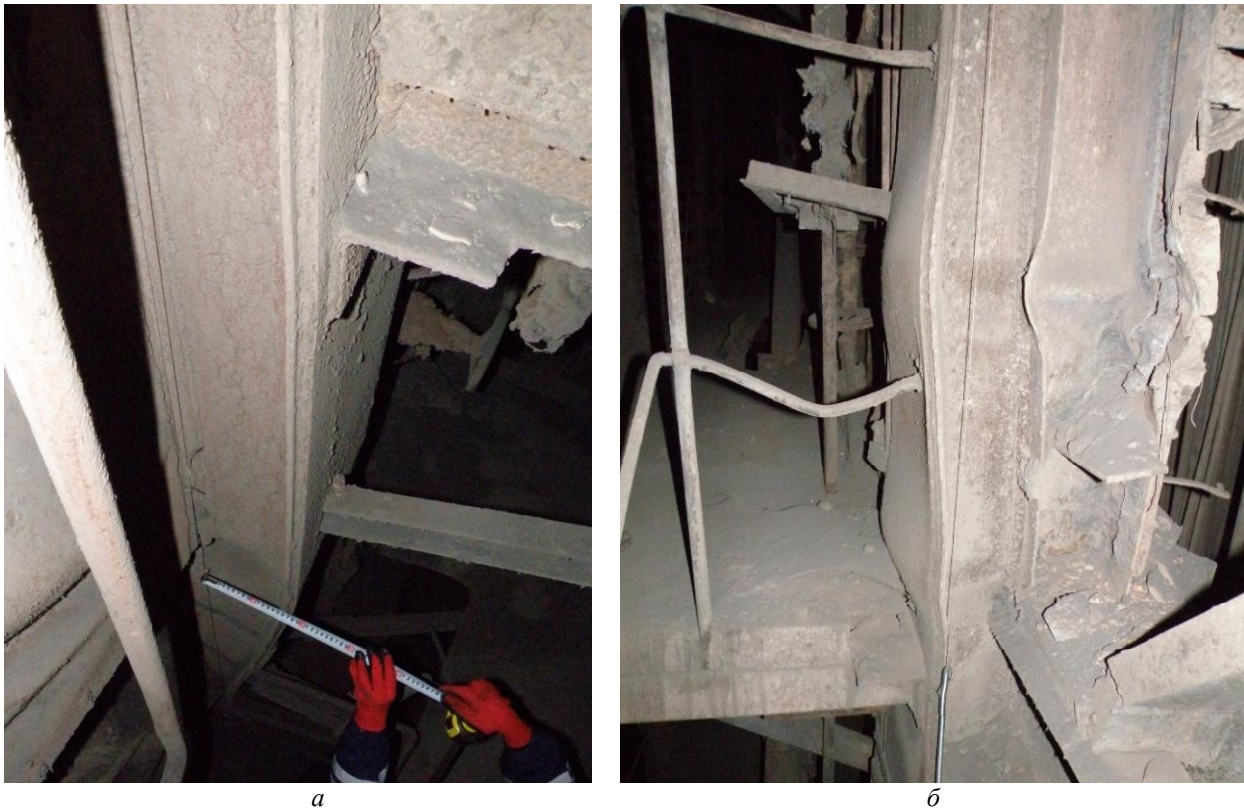
Рис. 5. Дефекти на ділянках колон К-2 ліва, К2-прав у площині конструкції на позначках 21.200...28.900: а – вигин колони К-2 ліва в площині конструкції на 160 мм в рівні позначок 21.200...28.900; б – місцеве змінання стінки та полиць двотаврів, вигин із площини на 100...110 мм колони К2-прав на позначці +23.80
